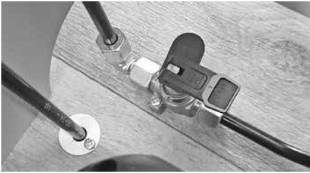
Isıtma sistemi kapatma vanası
